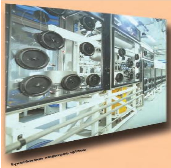
Σχήμα 4.3 Εγκατάσταση χειρισμού τρίτου. [ Β.1.8., σελ. 12 ]
