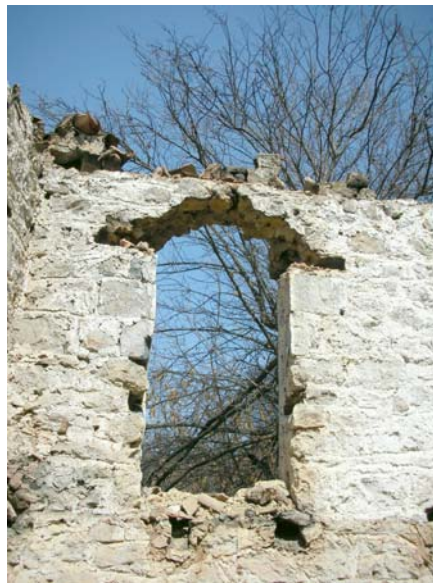
ΕΙΚΟΝΑ 5: ΚΑΥΣΗ ΞΥΛΙΝΟΥ ΥΠΕΡΘΥΡΟΥ. ΤΟΠΙΚΗ ΚΑΤΑΡΡΕΥΣΗ ΥΠΕΡΚΕΙΜΕΝΗΣ ΤΟΙΧΟΠΟΙΑΣ
