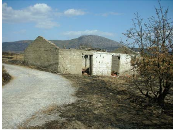
ΕΙΚΟΝΑ 11: ΛΟΞΕΣ ΡΩΓΜΕΣ ΣΤΗΝ ΤΟΙΧΟΠΟΙΑ (ΛΟΓΩ ΛΑΚΤΙΣΜΑΤΟΣ)
