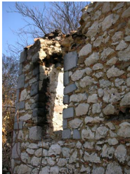
ΕΙΚΟΝΑ 7: ΚΑΥΣΗ ΞΥΛΙΝΟΥ ΥΠΕΡΘΥΡΟΥ. ΤΟΠΙΚΗ ΚΑΤΑΡΡΕΥΣΗ ΥΠΕΡΚΕΙΜΕΝΗΣ ΤΟΙΧΟΠΟΙΑΣ
