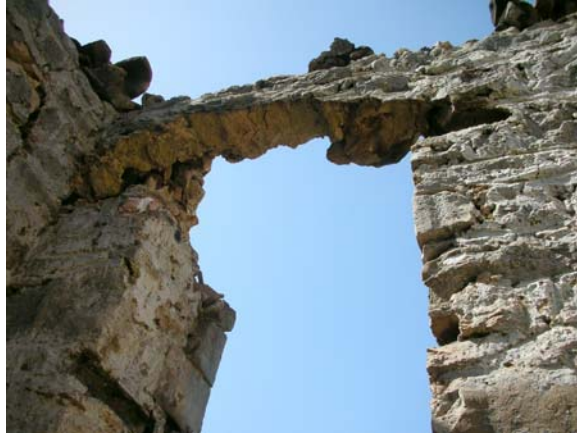
ΕΙΚΟΝΑ 6: ΚΑΥΣΗ ΞΥΛΙΝΟΥ ΥΠΕΡΘΥΡΟΥ. ΤΟΠΙΚΗ ΚΑΤΑΡΡΕΥΣΗ ΥΠΕΡΚΕΙΜΕΝΗΣ ΤΟΙΧΟΠΟΙΑΣ
