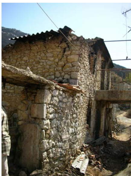
ΕΙΚΟΝΑ 8: ΚΑΤΑΡΡΕΥΣΗ ΣΤΕΓΗΣ, ΡΩΓΜΕΣ ΣΤΗΝ ΠΕΡΙΟΧΗ ΤΩΝ ΓΩΝΙΩΝ. ΔΙΑΚΡΙΝΕΤΑΙ ΚΑΙ ΤΟΠΙΚΗ ΚΑΤΑΡΡΕΥΣΗ ΤΟΙΧΟΠΟΙΑΣ ΠΑΝΩ ΑΠΟ ΤΑ ΑΝΟΙΓΜΑΤΑ
