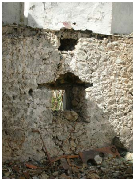
ΕΙΚΟΝΑ 9: ΚΑΥΣΗ ΞΥΛΙΝΟΥ ΥΠΕΡΘΥΡΟΥ. ΤΟΠΙΚΗ ΚΑΤΑΡΡΕΥΣΗ ΥΠΕΡΚΕΙΜΕΝΗΣ ΤΟΙΧΟΠΟΙΑΣ. ΔΙΑΚΡΙΝΟΝΤΑΙ ΡΩΓΜΕΣ ΣΧΗΜΑΤΙΣΜΟΥ ΘΟΛΟΥ
