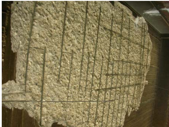
ΕΙΚΟΝΕΣ 7 ΚΑΙ 8: ΑΠΟΦΛΟΙΩΣΗ ΣΚΥΡΟΔΕΜΑΤΟΣ ΣΕ ΠΛΑΚΕΣ. ΑΠΩΛΕΙΑ ΣΥΝΑΦΕΙΑΣ ΜΕΤΑΞΥ ΡΑΒΔΩΝ ΟΠΛΙΣΜΟΥ ΚΑΙ ΣΚΥΡΟΔΕΜΑΤΟΣ
