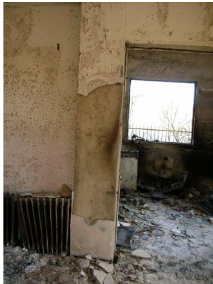
ΕΙΚΟΝΑ 2: ΑΠΟΚΟΛΛΗΣΗ ΕΠΙΧΡΙΣΜΑΤΟΣ ΑΠΟ ΥΠΟΣΤΥΛΩΜΑ, ΚΑΤΑΚΟΡΥΦΗ ΡΩΓΜΗ ΣΤΗΝ ΘΕΣΗ ΓΩΝΙΑΚΗΣ ΡΑΒΔΟΥ ΟΠΛΙΣΜΟΥ
