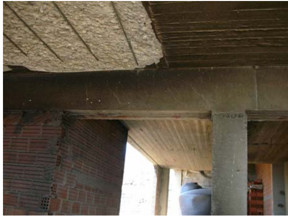
ΕΙΚΟΝΑ 10: ΔΙΑΤΜΗΤΙΚΕΣ ΡΩΓΜΕΣ ΣΕ ΔΟΚΟ
