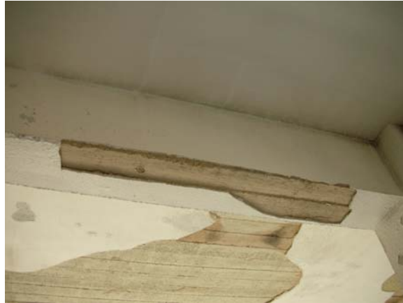
ΕΙΚΟΝΑ 1: ΑΠΟΚΟΛΛΗΣΗ ΚΑΙ ΠΤΩΣΗ ΕΠΙΧΡΙΣΜΑΤΟΣ ΑΠΟ ΠΛΑΚΑ ΚΑΙ ΔΟΚΟ. ΠΑΡΑΤΗΡΕΙΤΑΙ ΑΛΛΑΓΗ ΧΡΩΜΑΤΟΣ ΣΤΟ ΣΚΥΡΟΔΕΜΑ
