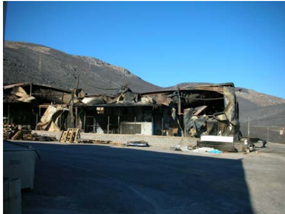
ΕΙΚΟΝΑ 11: ΚΑΤΑΡΡΕΥΣΗ ΜΕΤΑΛΛΙΚΩΝ ΦΟΡΕΩΝ ΣΤΕΓΗΣ
