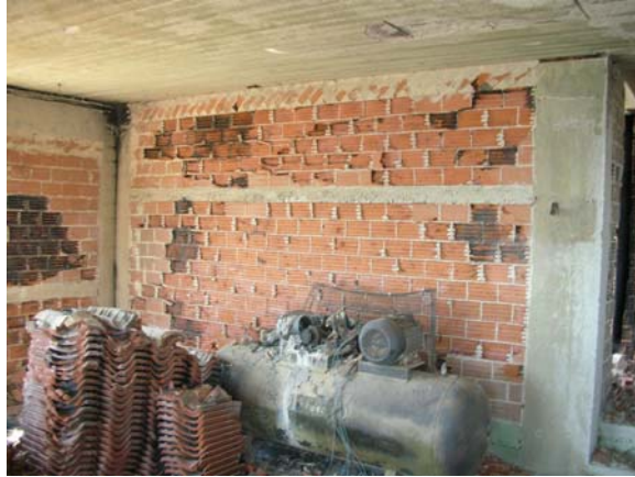
ΕΙΚΟΝΑ 6: ΑΠΟΦΛΟΙΩΣΗ ΟΠΤΟΠΛΙΝΘΩΝ ΣΕ ΤΟΙΧΟΥΣ ΠΛΗΡΩΣΕΩΣ
