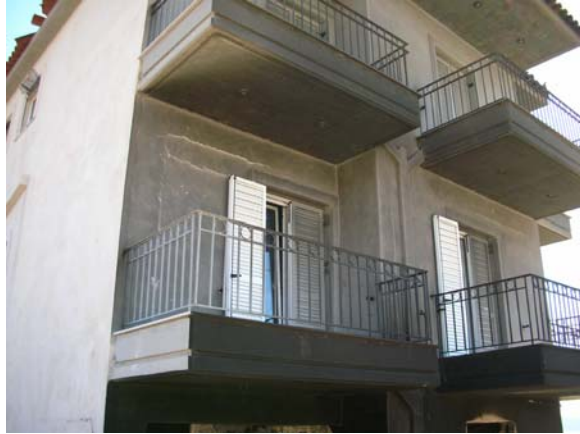
ΕΙΚΟΝΑ 9: ΑΠΟΚΟΛΛΗΣΗ ΦΕΡΟΝΤΟΣ ΟΡΓΑΝΙΣΜΟΥ ΚΑΙ ΤΟΙΧΩΝ ΠΛΗΡΩΣΕΩΣ
