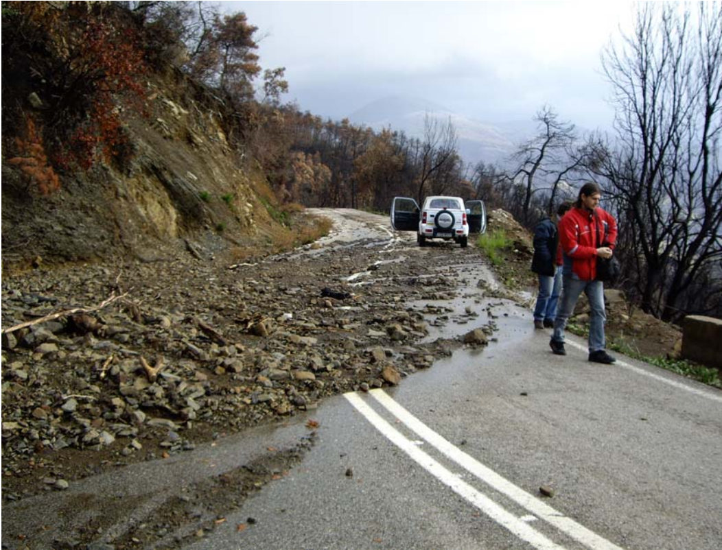
Εικόνα 10. Προβλήματα στο οδόστρωμα λόγω φερτών υλικών μετά από έντονη βροχόπτωση. Διαδρομή Σμέρνα – Αρτέμιδα.
