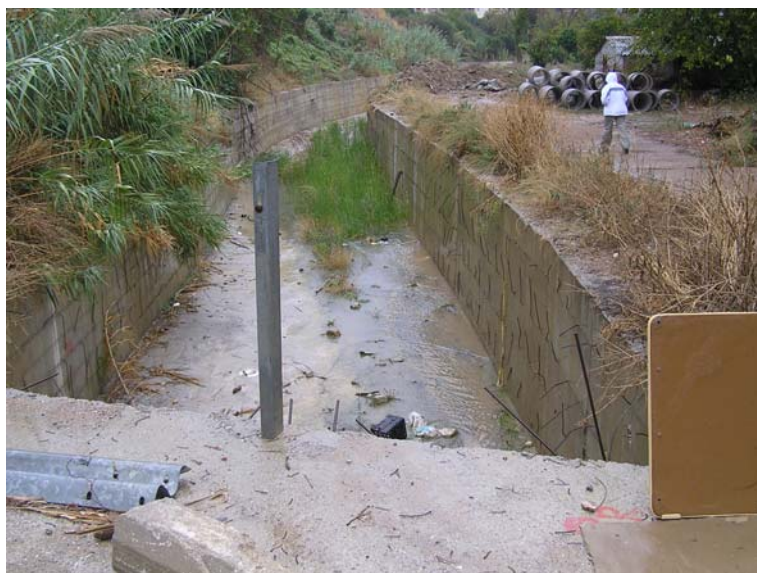
Εικόνα 8-7. Η είσοδος του εγκιβωτισμένου οχετού με τον οποίο ο χείμαρρος Ζαχάρως διασχίζει την πόλη, μετά από ασθενή βροχόπτωση.
