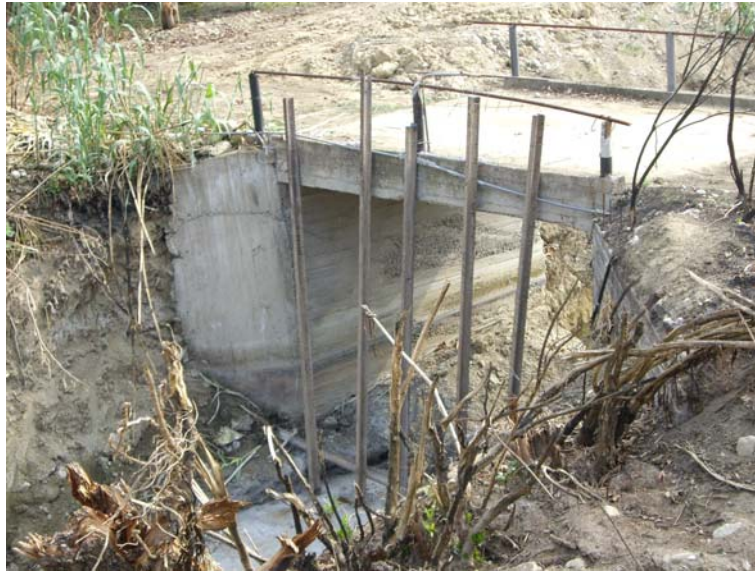
Εικόνα 8-5. Χτένια (debris racks) από χαλύβδινα στοιχεία κατάλληλης διατομής στην ανάντη πλευρά γέφυρας.
