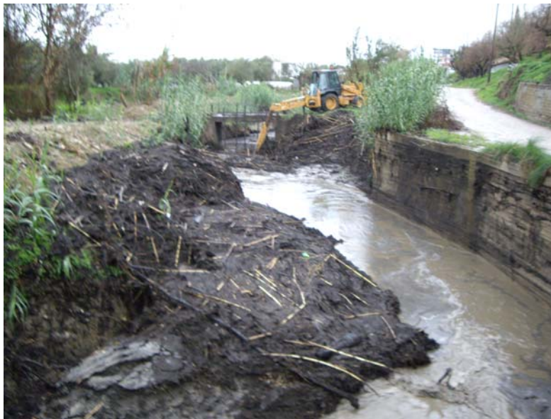
Εικόνα 8-6. Σημαντικές ποσότητες υλικών που συγκρατήθηκαν από τα χτένια σε μικρό γεφύρι ανάντη της Ζαχάρωσ.
