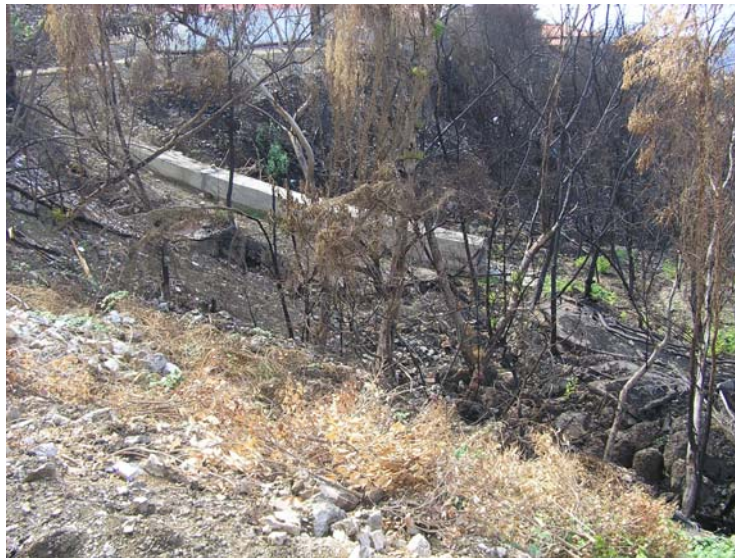
Εικόνα 3-27. Άποψη του σωληνωτού αγωγού παροχέτευσης επιφανειακών νερών, που εκβάλλει εντός της ζώνης των χαλαρών υλικών της αστοχίας στο χωριό Καλίδονα.
