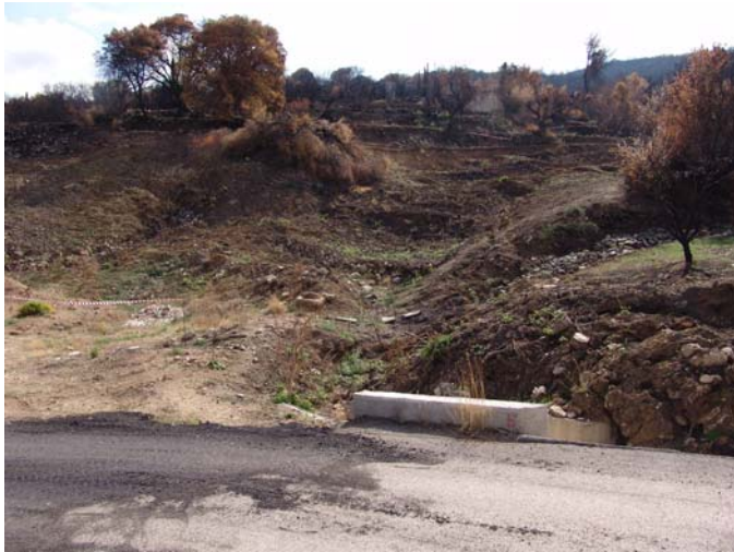
Εικόνα 3-17. Άποψη της αστοχίας ανάντη του δρόμου. Διακρίνεται η πρόσφατη επισκευή του οδοστρώματος.
