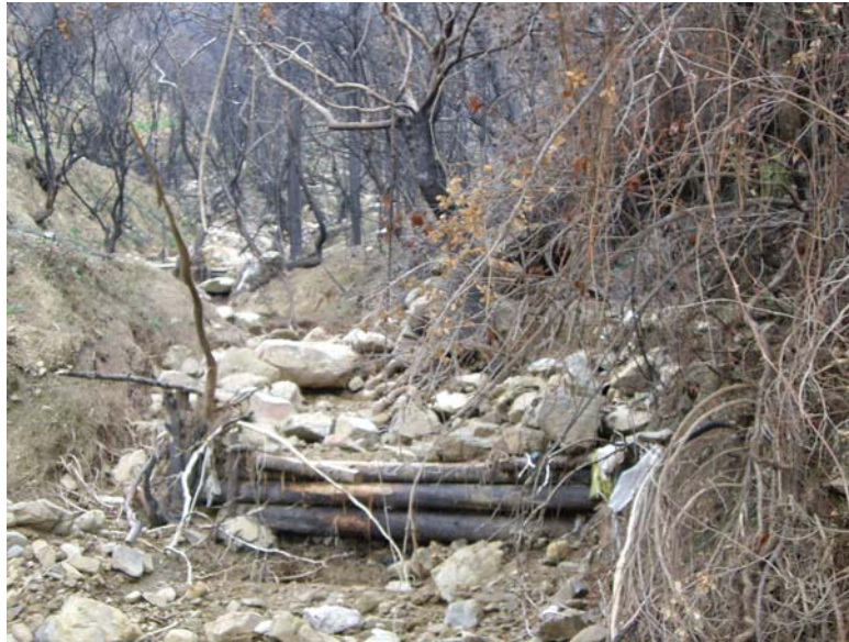
Εικόνα 8-3. Καλή λειτουργία ξυλοφράγματος.
