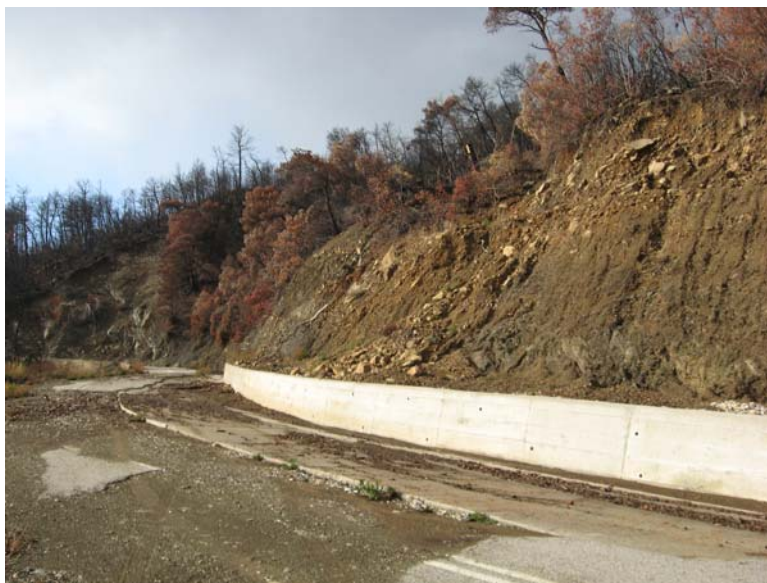
Εικόνα 3-19. Ροές χαλαρών υλικών μετά από βροχόπτωση. Τεχνητό πρανές του δρόμου Σμέρνα – Αρτέμιδα.
