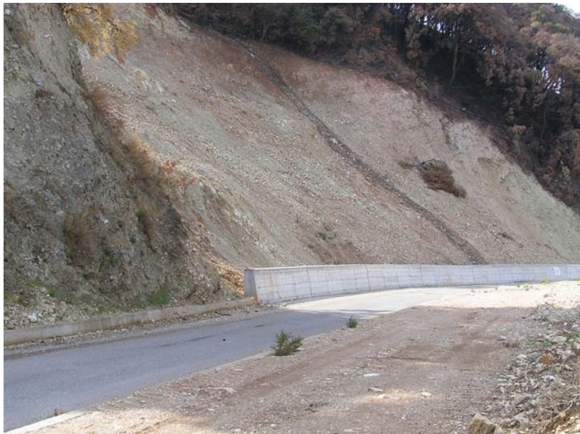
Εικόνα 3-14. Αστοχία τεχνητού πρσανούς στο δρόμο από Χρυσοχώρι προς Μηλέα.
