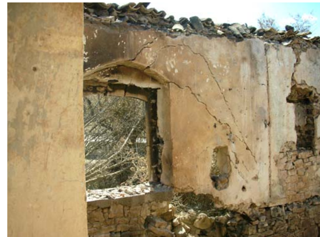
Λοξές ρωγμές στην τοιχοποιία. Αποδίδονται στην εμποδιζόμενη από τον ισχυρό εγκάρσιο πεσσό παραμόρφωση της τοιχοποιίας.
