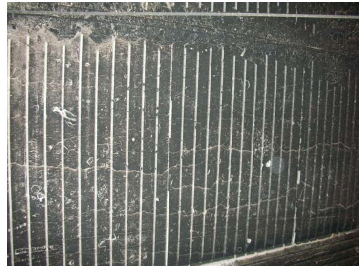
Ρωγμές στην πλάκα, παράλληλες προς τον οπλισμό. Διακρίνεται το αποτύπωμα του καμμένου μονωτικού υλικού.
