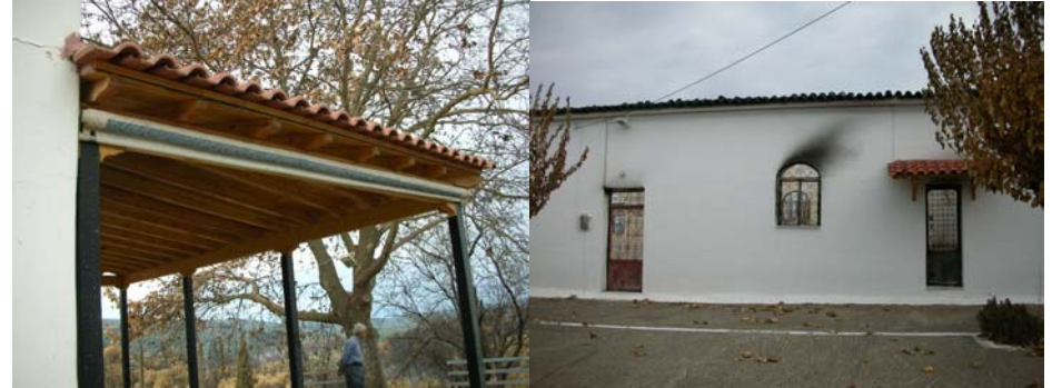
Άθικτο πλαστικό πέτασμα σε μικρή απόσταση από περιοχή στην οποία αναπτύχθηκαν μεγάλες θερμοκρασίες.
