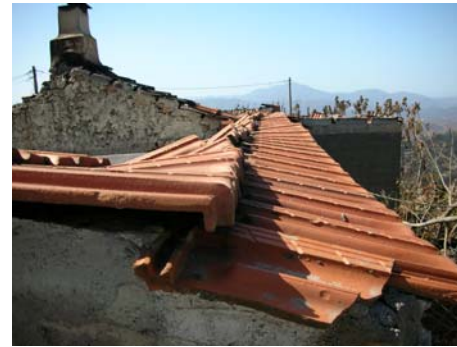
Από την κλίση των κεραμιδιών διακρίνεται η προς το εσωτερικό του κτηρίου κατάρρευση της στέγης που κάηκε.
