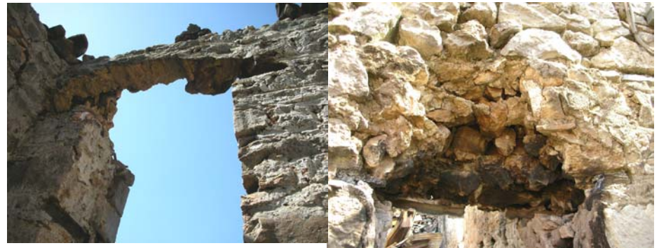
Αποδιοργάνωση τοιχοποιίας μετά από την καύση του ξύλινου υπερθύρου
