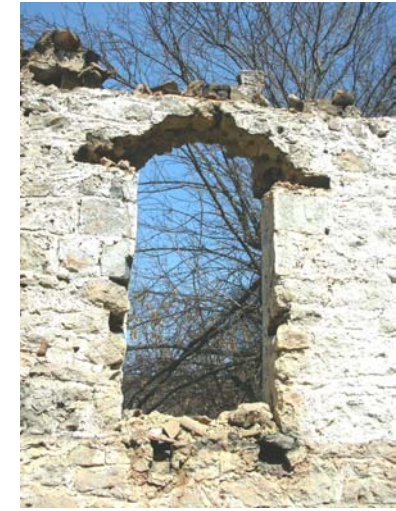
Καύση ξύλινου υπερθύρου. Κατάρρευση ανακουφιστικού τόξου.
