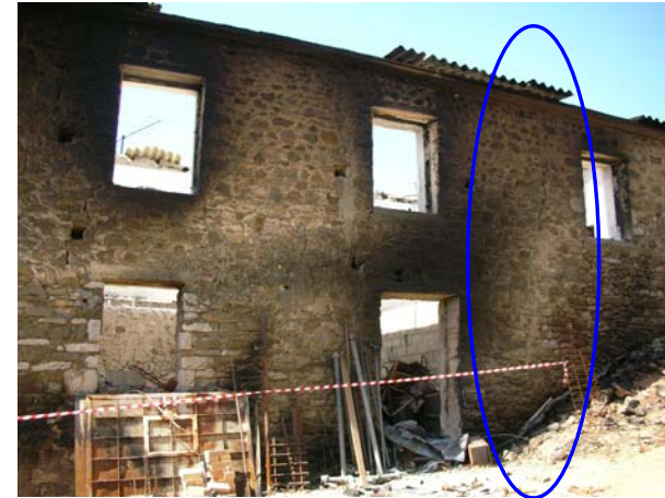
Διακρίνεται επισκευασμένη ρωγμή προγενέστερη της πυρκαγιάς
