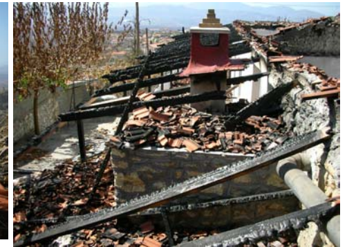
Καύση δοκών/πλήρης καύση πετρώματος υποστέγου. Πτώση και θραύση κεραμιδιών.
