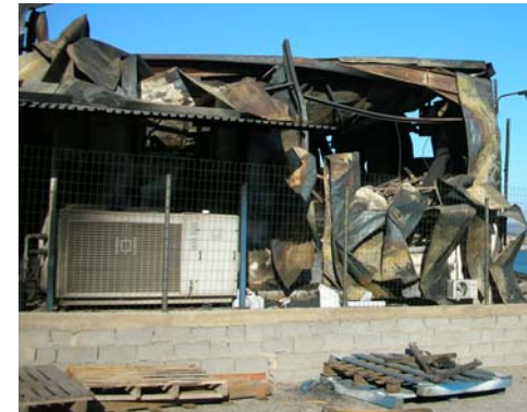
Αστοχία μεταλλικού πλαισίου
