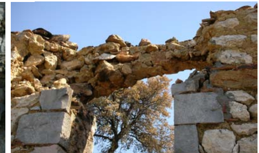
Αποδιοργάνωση τοιχοποιίας μετά από την καύση του ξύλινου υπερθύρου
