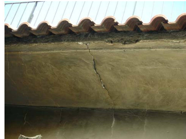
Ρωγμή σε πλάκα προβόλου. Συνεχίζεται στην δοκό.
