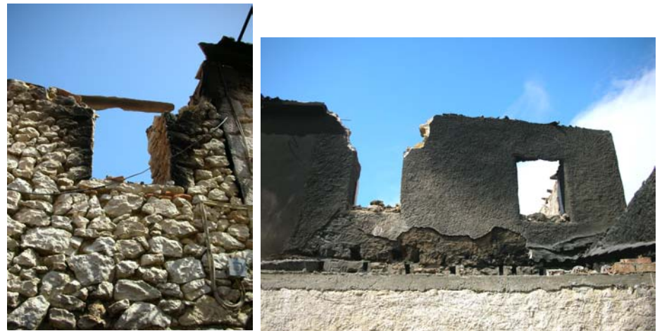
Κατάρρευση της υπερκείμενης τοιχοποιίας μέχρι την στέψη του τοίχου, μετά από την καύση των ξύλινων υπερθύρων.
