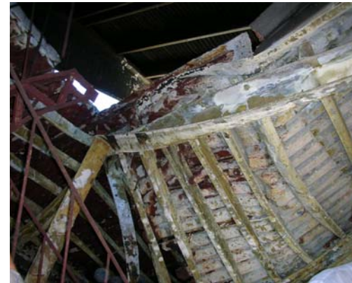
Μεταλλικό μεσοπάτωμα, μετά την κατάρρευσή του.
