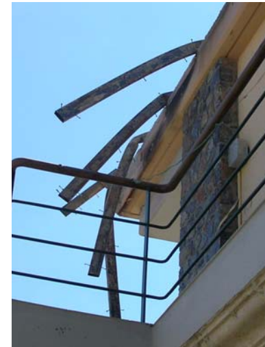
Παραμόρφωση μεταλλικών δοκών
