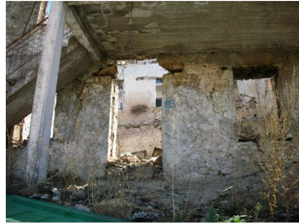
Διατμητικές ρωγμές σε πεσσούς. Διακρίνεται η πλάκα Ω.Σ. στην στάθμη της οροφής ισογείου.
