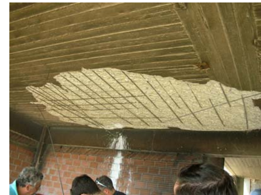
Αποφλοίωση πλάκας. Απώλεια της συνάφειας του οπλισμού.
