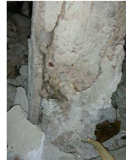
Λεπτομέρεια: Ποιότητα σκυροδέματος στην περιοχή της βάσης του υποστυλώματος.
