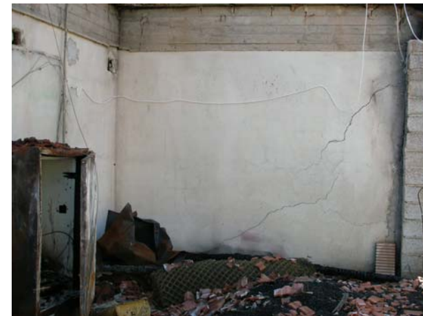
Διατμητικές ρωγμές σε τοίχους. Διακρίνεται η ισχυρή δοκός Ω.Σ. στην στέψη της τοιχοποιίας.
