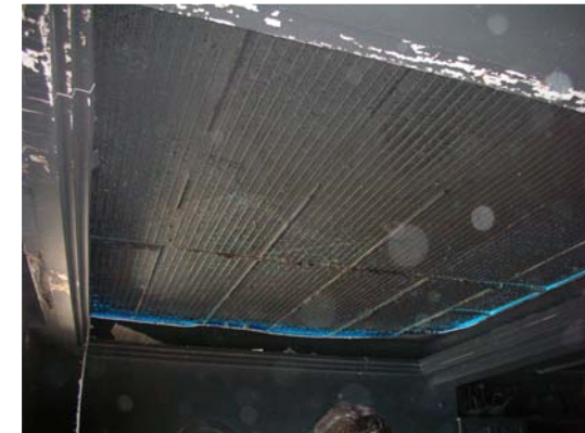
Πτώση επιχρίσματος. Διακρίνεται ρωγμή στην πλάκα, το αποτύπωμα του καμμένου μονωτικού υλικού και υπολείμματά του στις ακραίες περιοχές της πλάκας.
